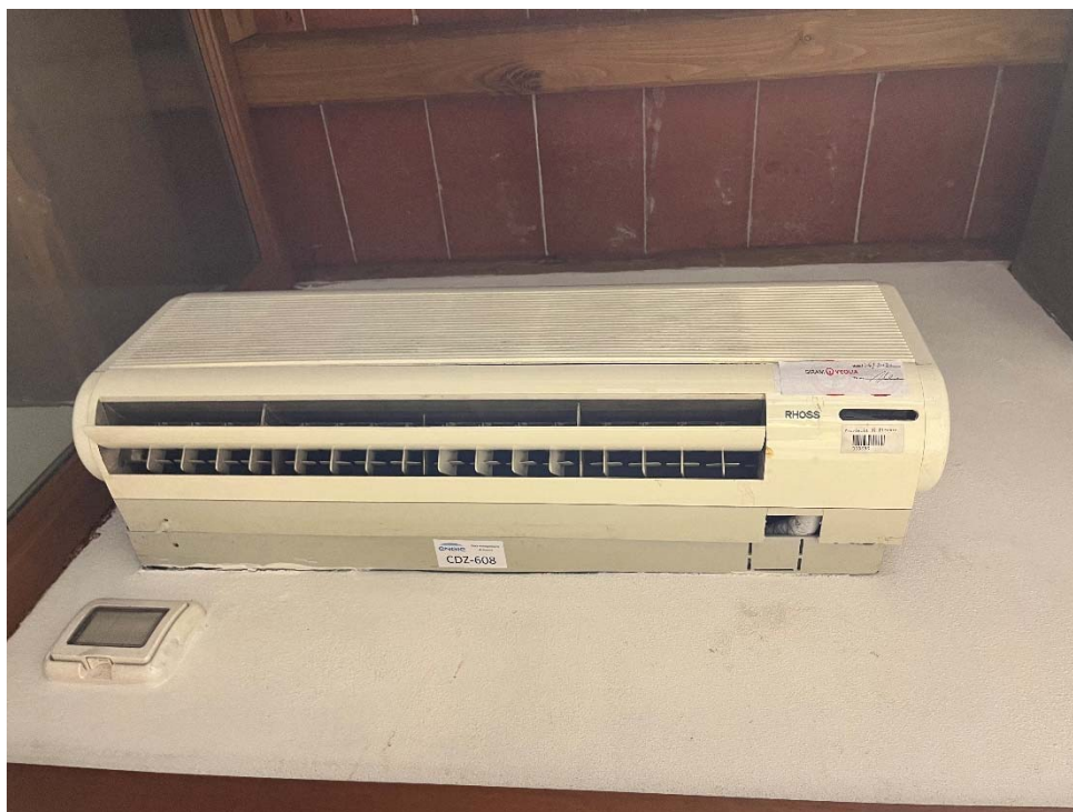
Foto n. 7 – Ventilconvettore a parete esistente
